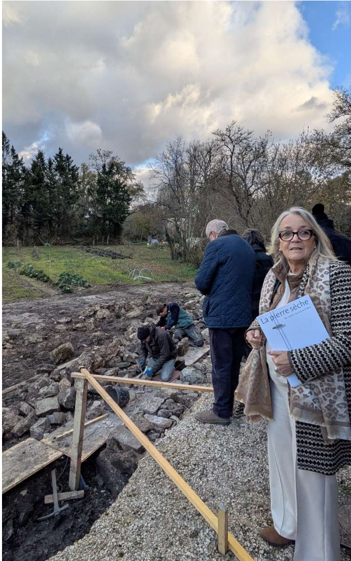
Visite par le PETR Vidourle Camargue d'un chantier-école à Vindrac d'Alayrac (Tarn) sur invitation du PETR Albigeois et Bastides
